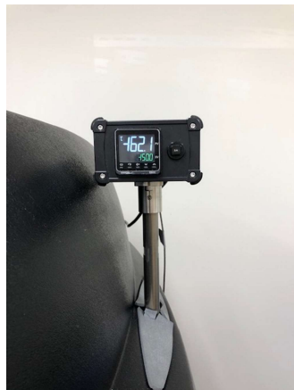
温度監視ユニット
